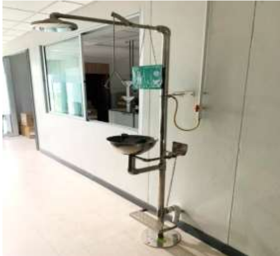
รูปที่ 3.14 ที่ล้างตัวฉุกเฉิน
